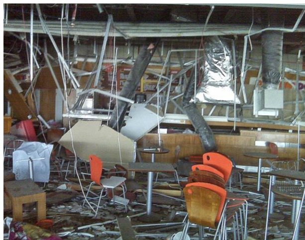
Herabgefallene Deckenelemente samt Kabeln und Lüftungsrohren
