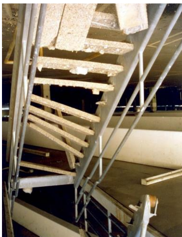
Stark beschädigter Treppenlauf
