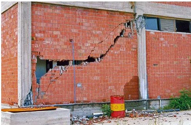
Abb. 2.4.1 > Druckdiagonale durch Mauerwerkswand und Schädigung der Stahlbetonstützen
