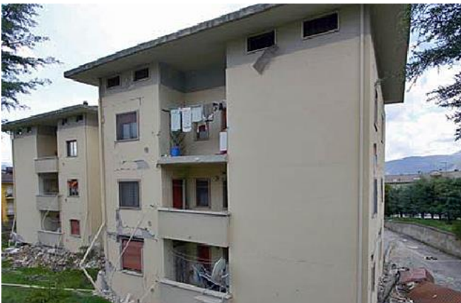
Abb. 2.6.3 > Brüstung im oberen Geschoss herausgefallen
