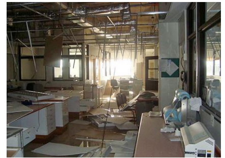
Globales Versagen Unterdeckenrost, Unterdecken- und Beleuchtungselemente im Krankenhaus von Los Angeles
