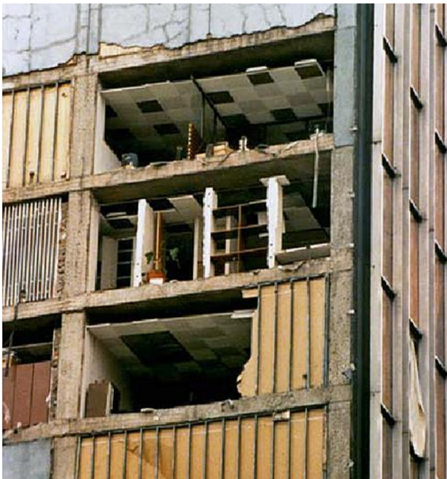
Abb. 2.5.3 > Versagen aus der Ebene einer vorgehängten Fassade
