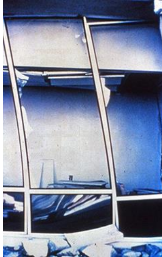
Abb. 2.8.2 > verbogene Fensterrahmen in weichem Gebäude
