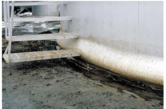
Abb. 2.17.4 &gt; Ausgebeulte Tankwand (sog. «Elefantenfuss»)
