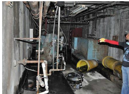
Mit Öl und Wasser gefluteter Keller eines Kraftwerks
