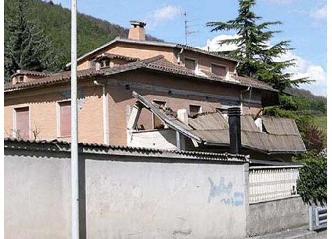
Abb. 2.9.2 &gt; Eingestürztes Vordach
