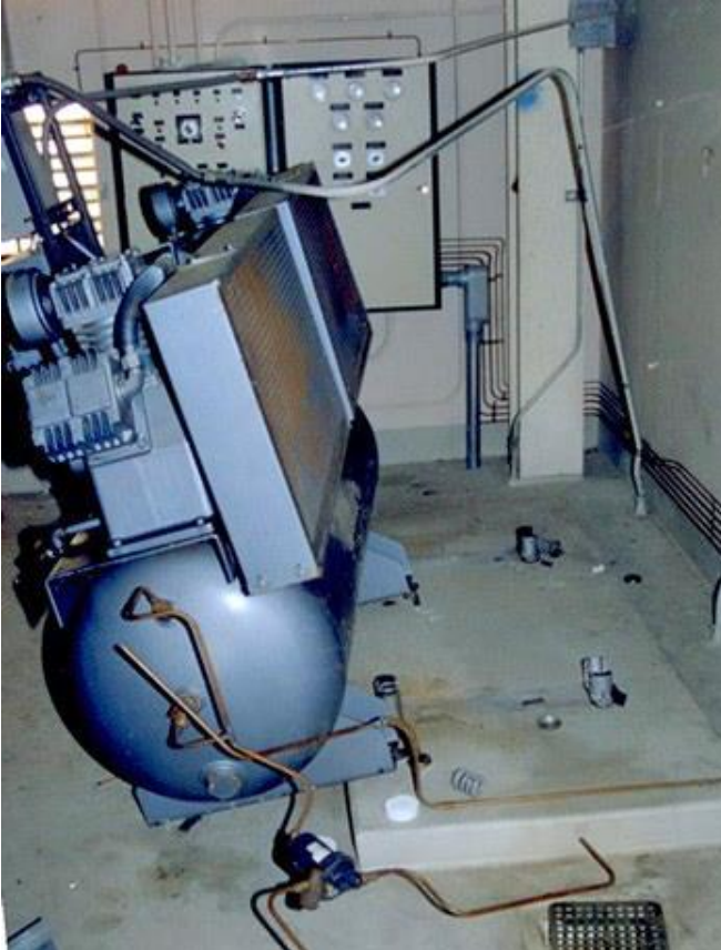
Abb. 2.20.1 > Versagen der Lagerung einer schwingungsisolierten Anlage
