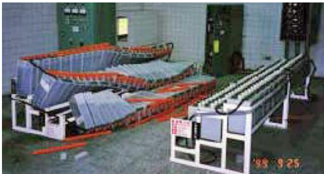
Abb. 2.11.1 &gt; Schäden an Regal für Notstrombatterien und Herausfallen der Batterien
