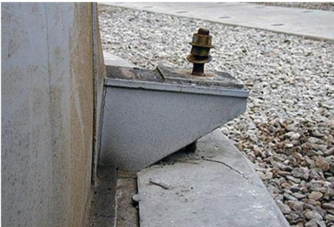
Abb. 2.17.3 &gt; Beschädigte Verankerung
