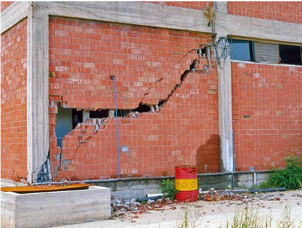
Abb. 1.4 > Schäden an Stützen durch Mauerwerksausfachung, Türkei Erdbeben 1998
