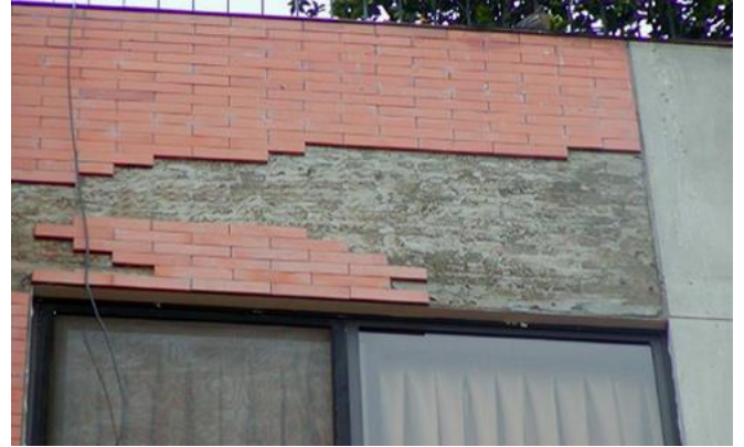
Abb. 2.5.2 > Ablösung von geklebten Elementen
