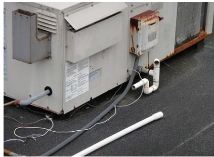
Unbefestigte Rohrleitung ist an Verbindung abgebrochen
