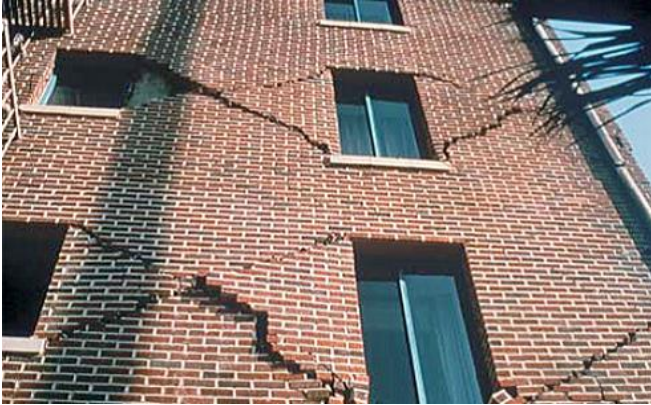
Abb. 2.5.1 > Kreuzrisse zwischen Fenstern
