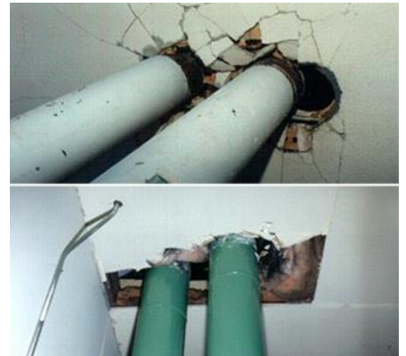
Abb. 2.18.6/2.18.7 > Schaden bei Wanddurchbrüchen
