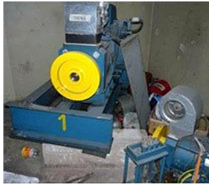
Abb. 2.19.2 > Ungenügend befestigte Antriebseinheit
