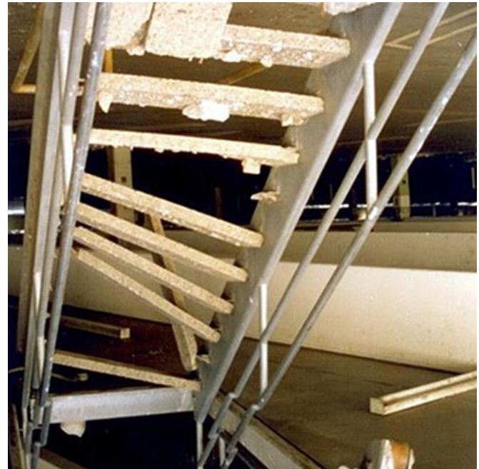
Abb. 2.7.4 &gt; Herabgefallene Treppentritte
