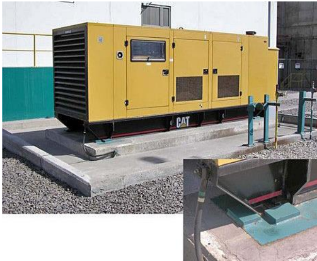
Abb. 2.16.7 > horizontaler Anschlag bei Generator
