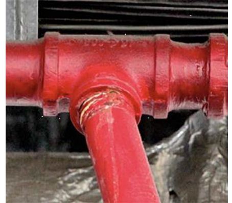
Abb. 2.18.3 > Schaden bei Verzweigung
