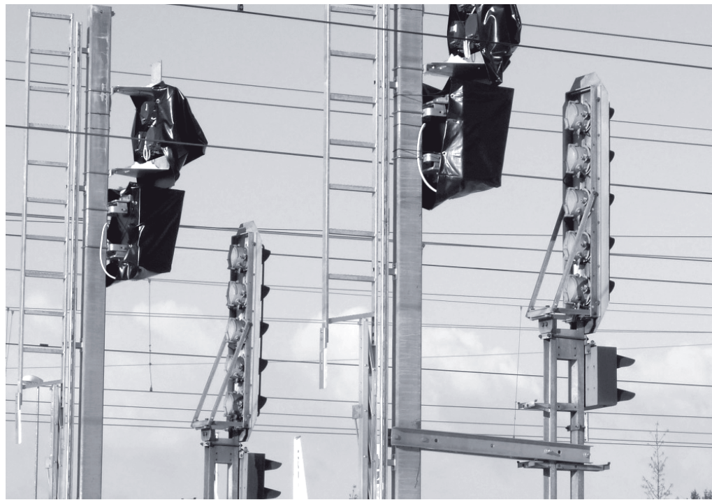
Ersatz der L-Signalisierung durch N-Signalisierung in Langenthal.
