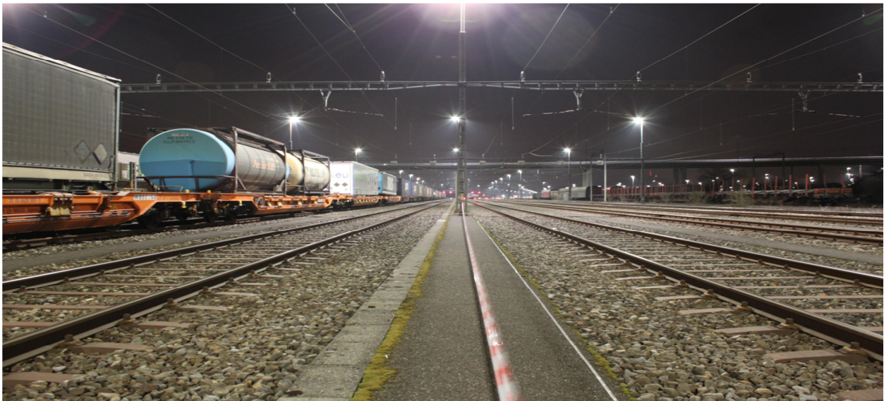
Gleisfeldbeleuchtung am Rangierbahnhof Limmattal mit LED-Leuchten (ab 2014).
