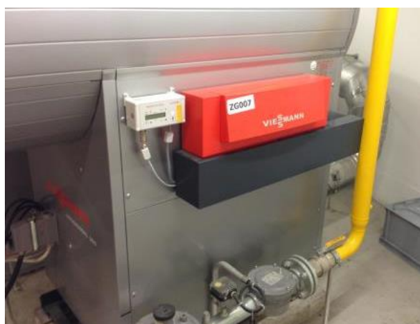
Eingebauter HeizPro am Heizungskessel im Bahnhof Zug.
