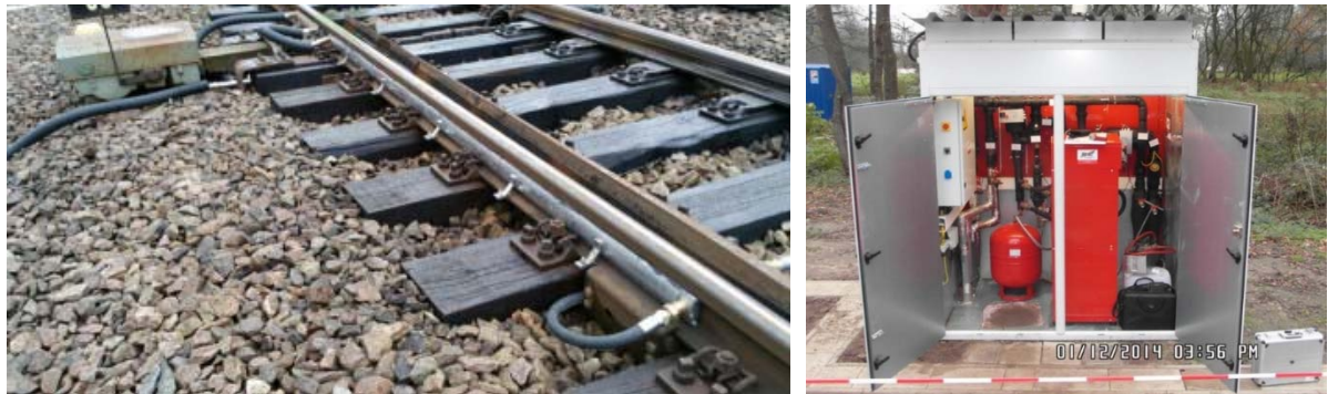
Abb. 7 System Triple-S: Wärmeübertrager an der Stockschiene und Kabine mit Wärmepumpe und Steuerschrank (© Triple-S GmbH)
