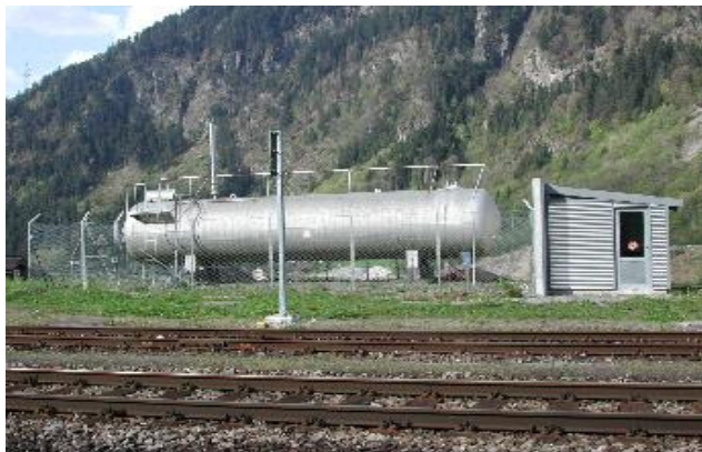
Propanbehälter zur Versorgung einer Gasweichenheizung
