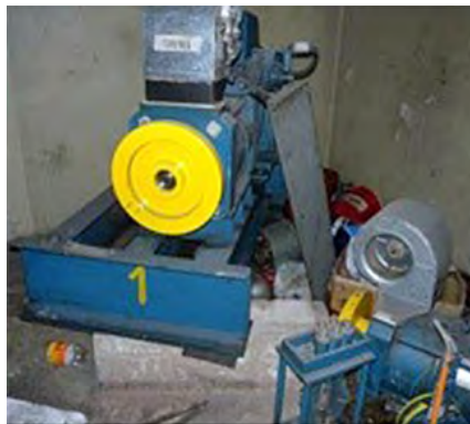
Fig. 2.19.2 > Unité d'entraînement mal fixée
