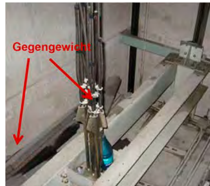
Fig. 2.19.3 > Chute de contrepoids et dégâts aux poutres transversales
