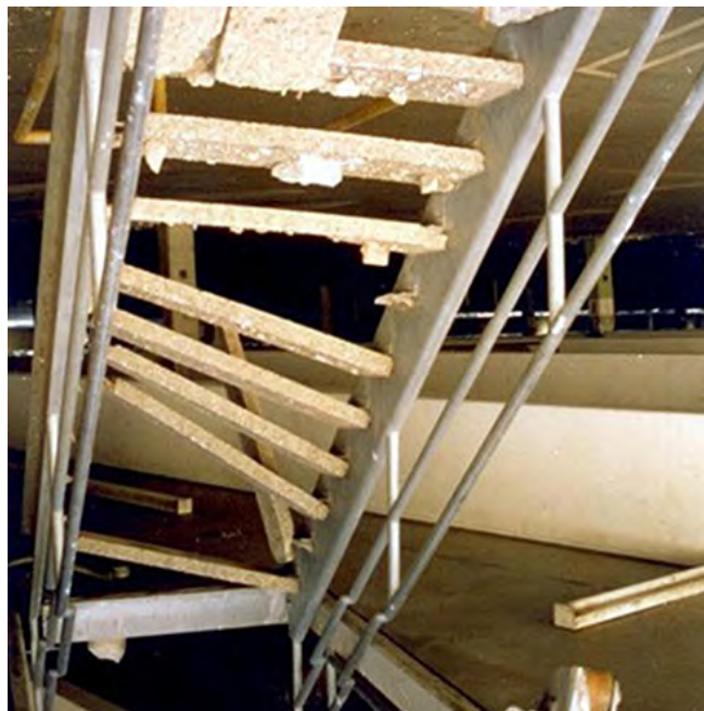
Fig. 2.7.4 &gt; Dislocation de marches d'escalier
