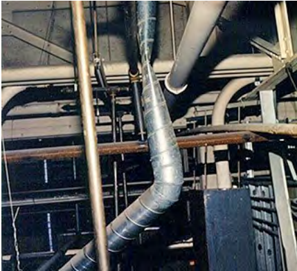
Fig. 2.18.1 &gt; Dégâts dus à des chocs
