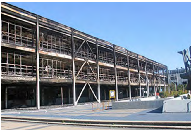
Fig. 2.24.3 &gt; Incendie déclenché par des substances dangereuses
