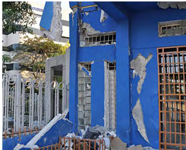
Fig. 2.8.3 > Dommages subis par un vitrage constitué de briques en verre
