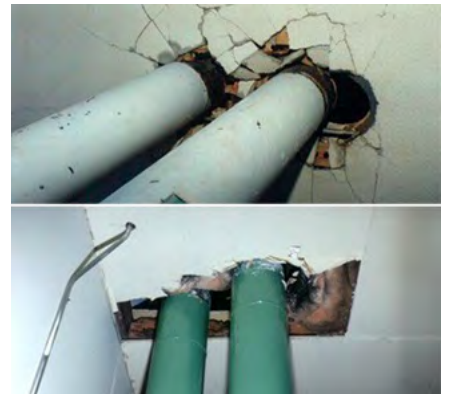
Fig. 2.18.6/2.18.7 &gt; Dommages à des passages à travers des murs
