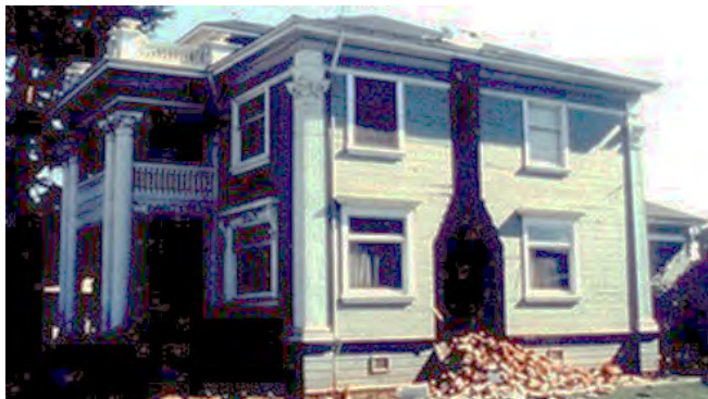
Fig. 2.10.1 > Effondrement d'une cheminée
