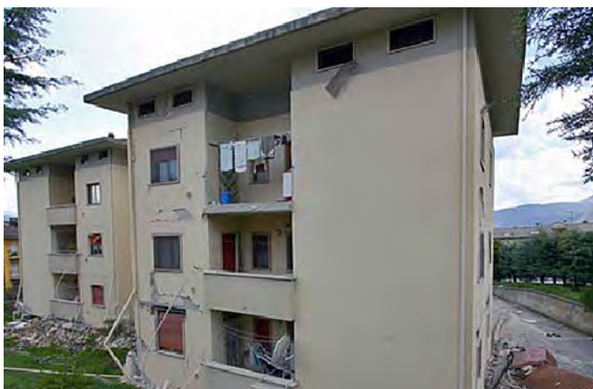
Fig. 2.6.3 > Chute du parapet de l'étage supérieur
