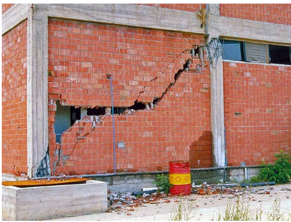
Fig. 1.4 > Dommages à des colonnes causés par le remplissage en maçonnerie, Turquie, séisme de 1998
