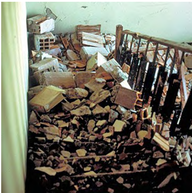
Fig. 2.7.3 &gt; Décombres obturant une volée d'escaliers
