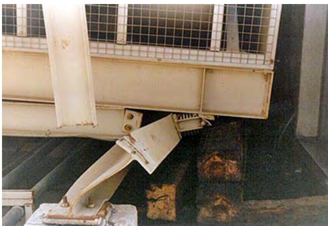
Fig. 2.16.3 et 2.16.4 &gt; Glissements/instabilités
