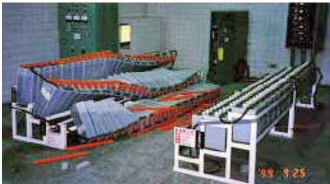
Fig. 2.11.1 > Dégâts subis par un châssis sur lequel étaient posées des batteries de secours et chute de celles-ci
