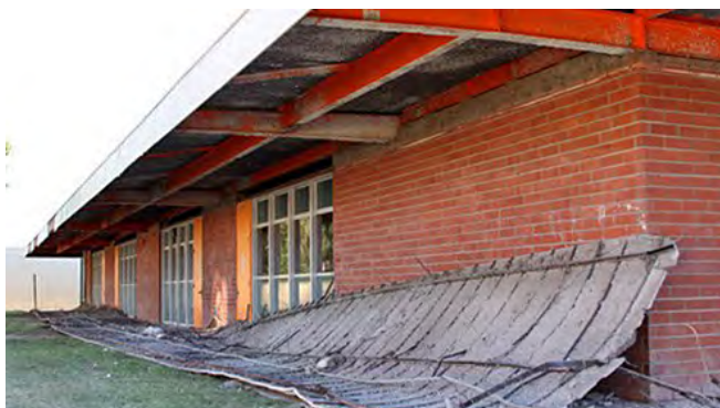
Fig. 2.10.3 et 2.10.4 > Décrochage de la sous-toiture et éclatements dans le crépi
