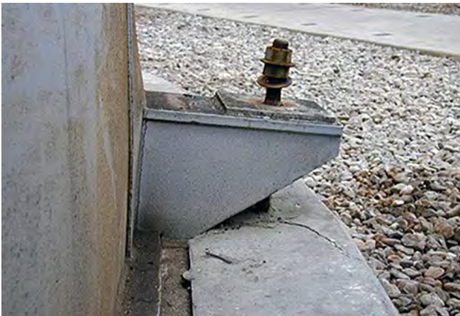
Fig. 2.17.3 &gt; Fixation endommagée
