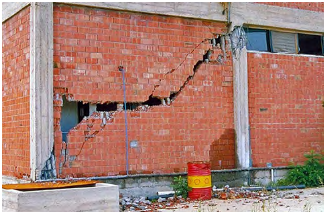
Fig. 2.4.1 > Rupture d'une diagonale sollicitée en compression dans la maçonnerie et endommagement des colonnes en béton armé
