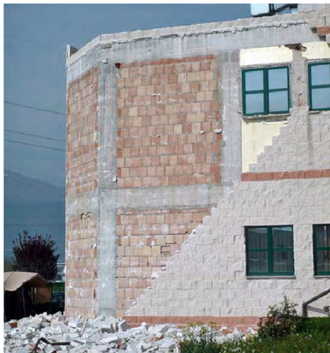
Fig. 2.5.4 > Chute d'une façade en maçonnerie préfabriquée
