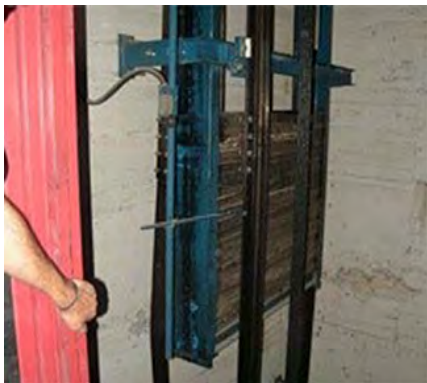
Fig. 2.19.1 > Rails de guidage déformés par des contrepoids
