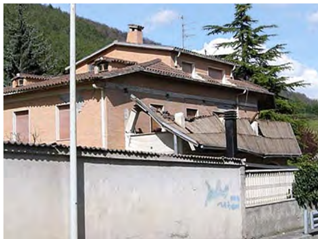
Fig. 2.9.2 &gt; Avant-toit effondré
