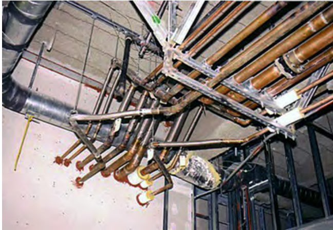
Fig. 2.18.10 > Raccords flexibles au droit de traversées murales, contreventement de voies de conduites
