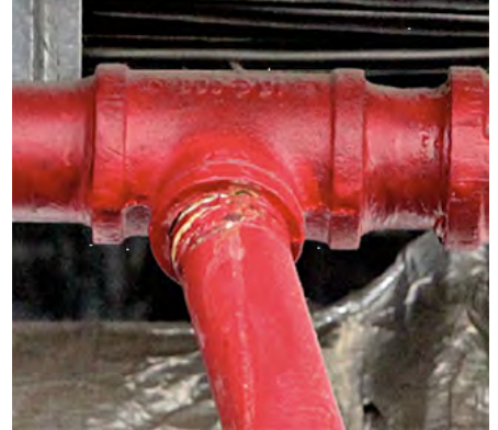
Fig. 2.18.3 &gt; Dégâts à un embranchement
