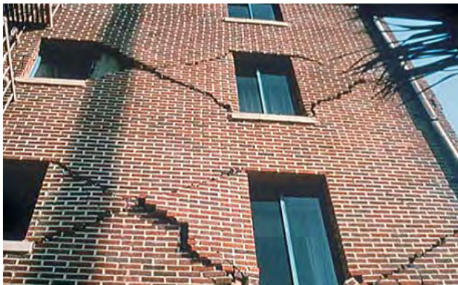
Fig. 2.5.1 > Fissures en croix entre fenêtres
