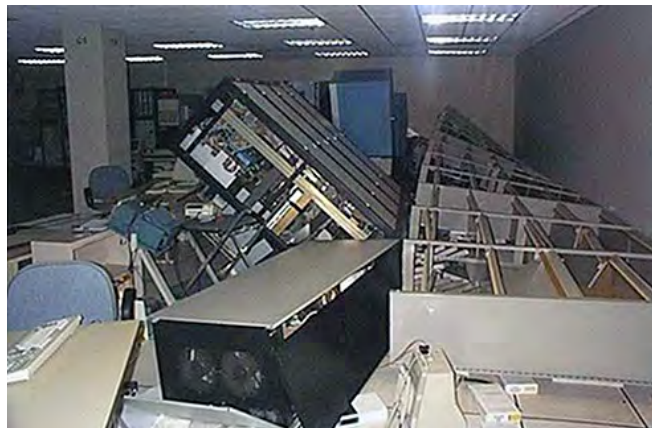
Fig. 2.21.2 &gt; Racks d'ordinateurs renversés
