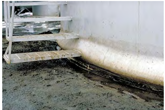
Fig. 2.17.4 &gt; Voilement de la paroi d'une citerne («pied d'éléphant»)
