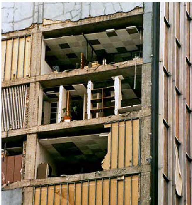
Fig. 2.5.3 > Rupture d'une façade suspendue
